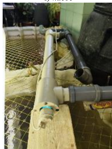
е) система трубопроводов и УФ обеззараживание
